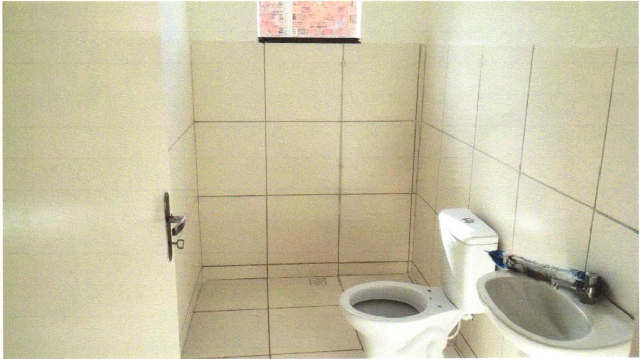
FOTO 13 – REVESTIMENTO CERÂMICO PARA PISO COM PLACAS TIPO ESMALTADA EXTRA DE DIMENSÕES 45X45 CM APLICADA EM AMBIENTES DE ÁREA MAIOR QUE 10 M2. AF_06/2014
