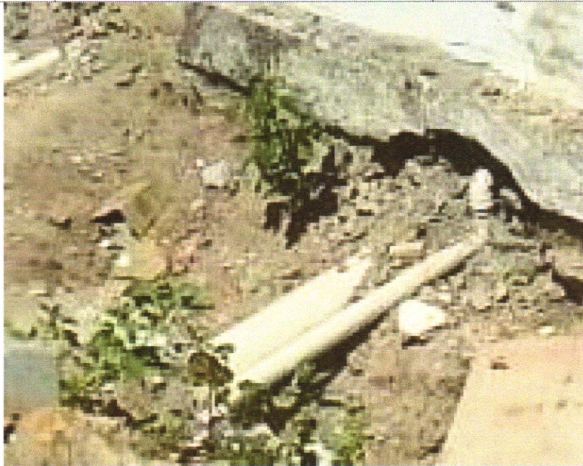
FOTO 41- TUBO DE PVC BRANCO PARA REDE COLETOIRA DE ESGOTO CONDOMINIAL DE PAREDE MACIÇA, DN 100 MM, JUNTA ELÁSTICA - FORNECIMENTO E ASSENTAMENTO. AF_01/2021
